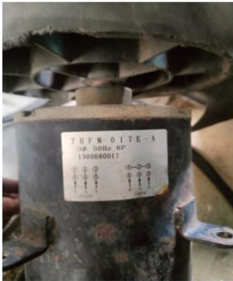
Nameplate Motor Fan Outdoor
