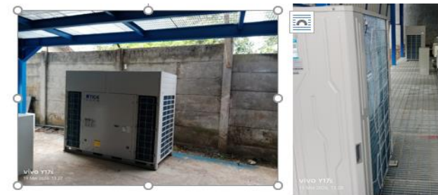
Outdoor unit zona 5 dan 7 pada Mezzanine C
