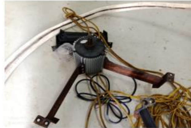
Motor Fan Chiller kompresor 2
