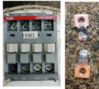
Kontaktor motor fan chiller kompresor 2 HMI 1 6A
