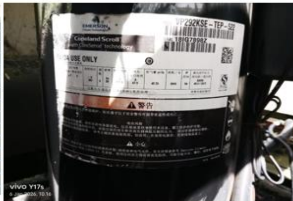
Kompresor 2Chiller 2 HMI 1 6A
