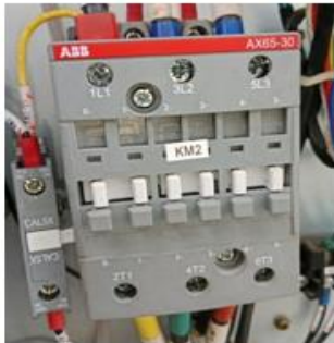
Kontak tambahan Kompresor 2 Chiller 2 HMI 1 6A
